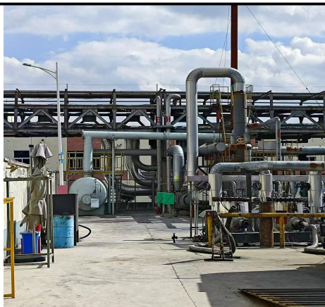
洗油喷淋塔+活性炭吸附
