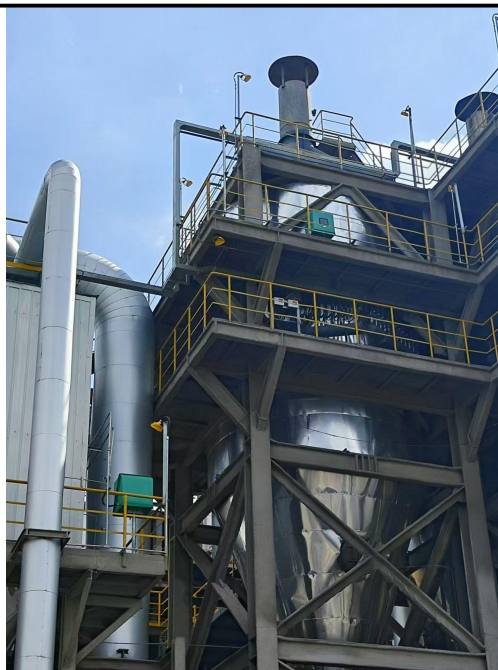
再处理袋滤器及 26m 排气筒
