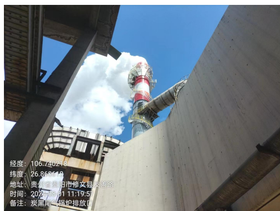
炭黑锅炉排气筒
