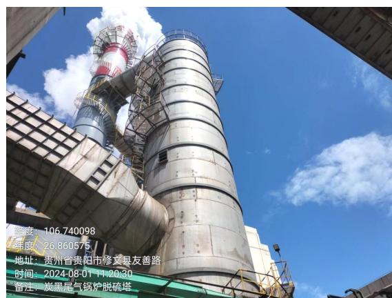
炭黑锅炉脱硫塔
