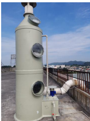
碱性喷淋塔、排气筒
