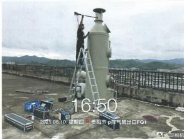
排气筒出口 FQ1
